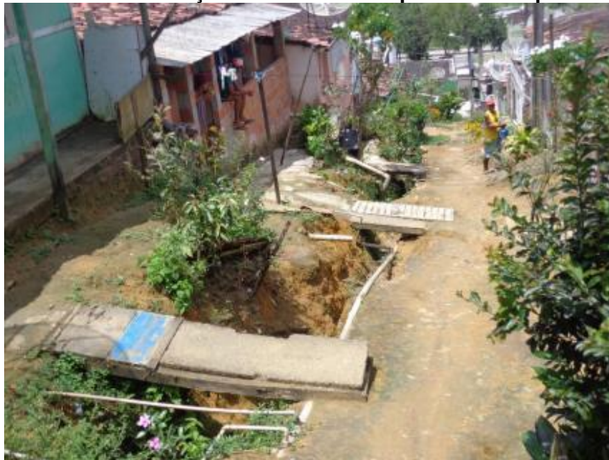
Figura 41 - Passarelas de madeiras improvisadas para passagem dos pedestres e instalações hidráulicas improvisadas aparentes
