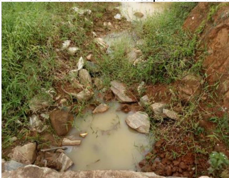
Figura 26 - Desmoronamento do lado esquerdo do Muro de testa.
