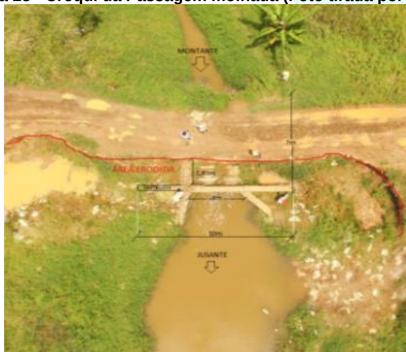
Figura 23 - Croqui da Passagem molhada (Foto tirada por drone)
