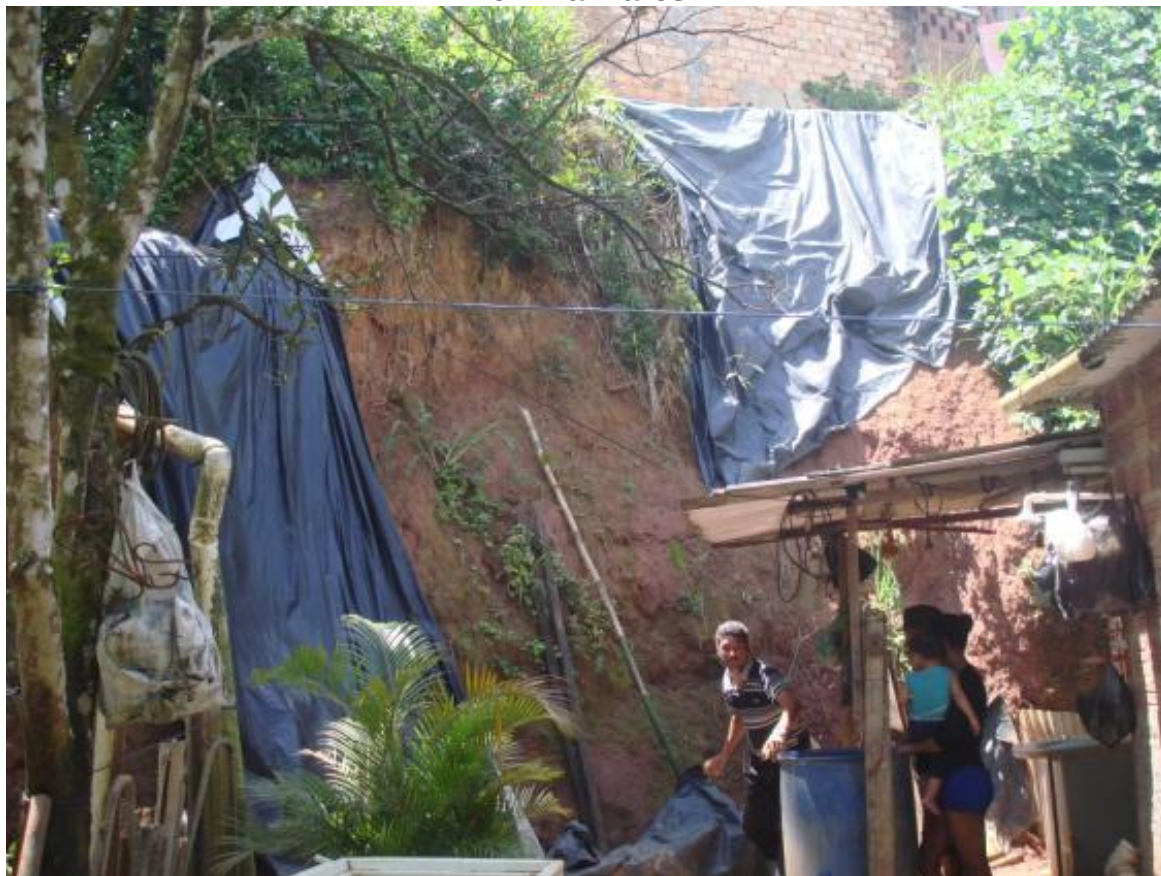
Figura 20 - Deslizamento recente ocorrido em residência em área de risco em Palmares
