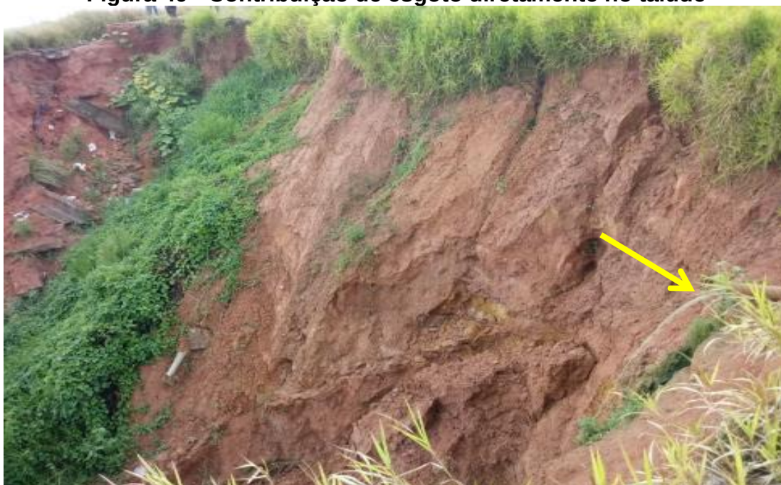
Figura 49 - Contribuição de esgoto diretamente no talude
