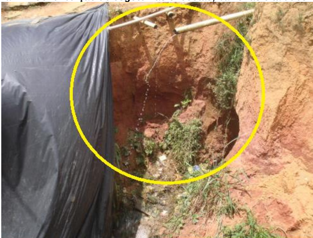
Figura 22 - Contribuição de esgoto nas encostas, barreiras e taludes
