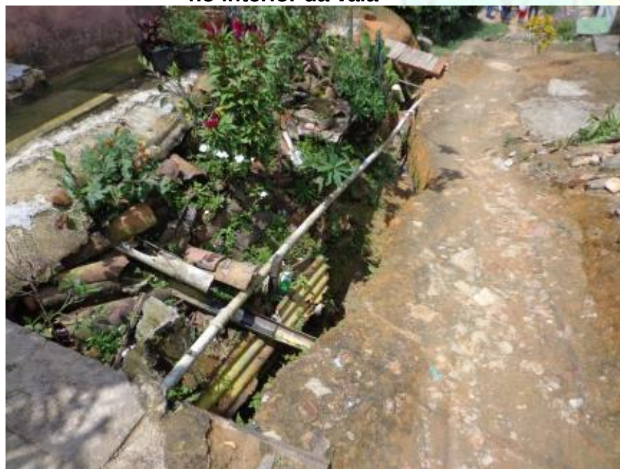
Figura 42 - Tubulações de esgoto sendo despejados de maneira aleatória no interior da vala
