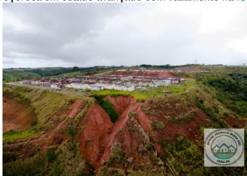
Figura 45- Voçoroca em estado avançado com vazamento na rede de esgoto
