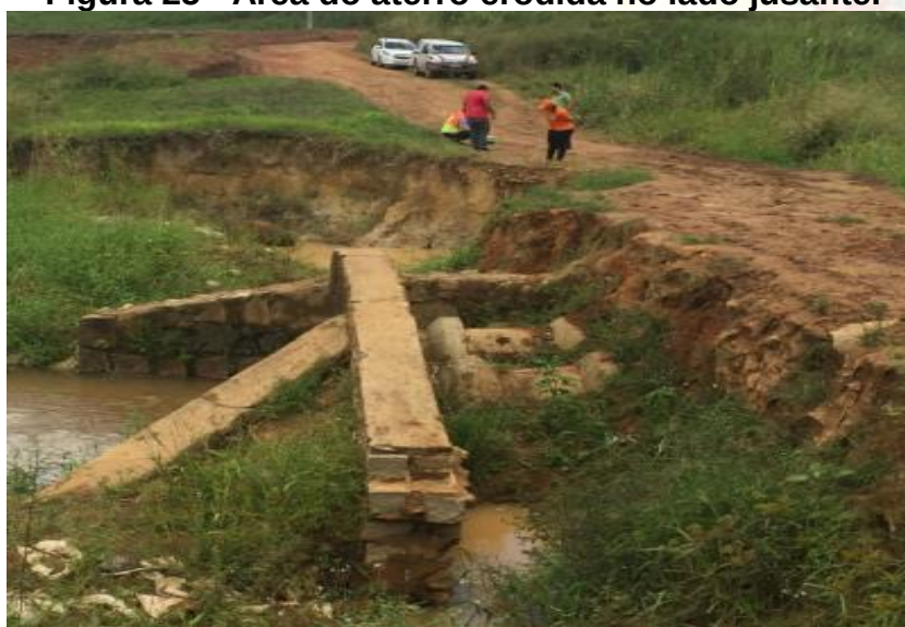
Figura 25 - Área do aterro erodida no lado jusante.
