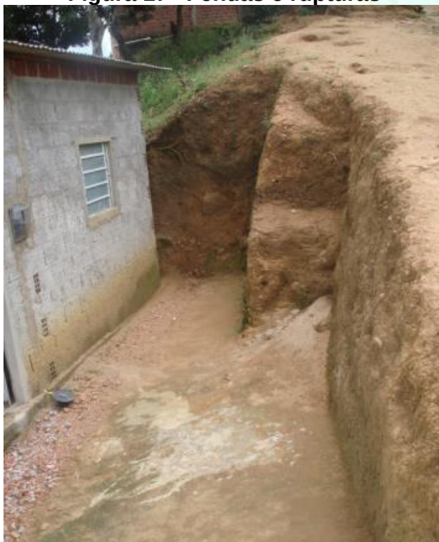
Figura 17 - Fendas e rupturas
