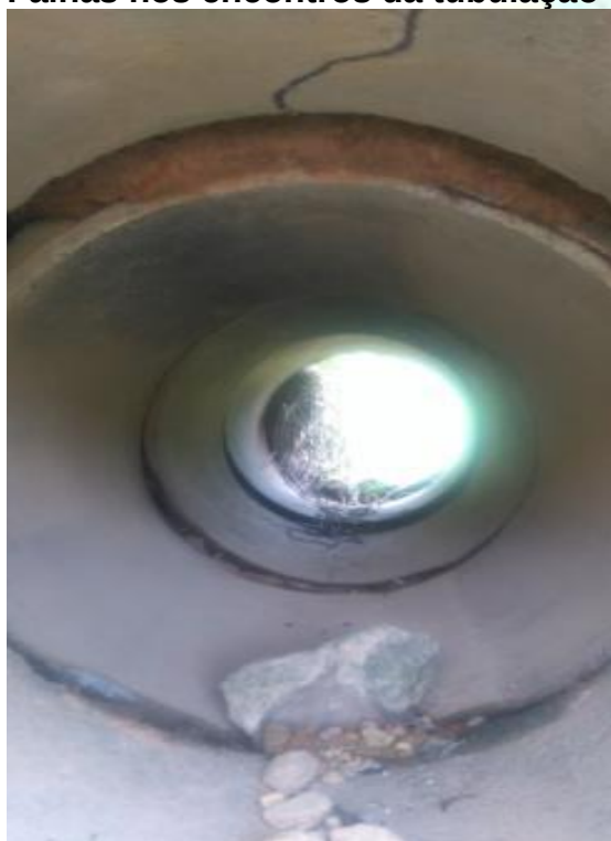
Figura 35 - Falhas nos encontros da tubulação de concreto
