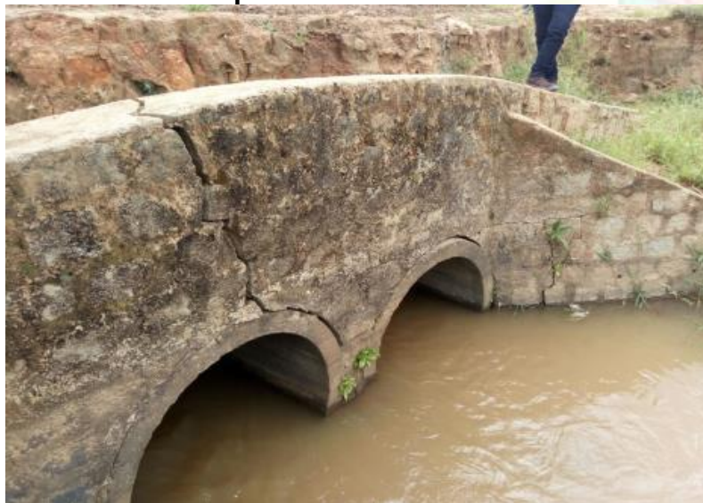
Figura 27 - Fissuras na parede de testa acima dos tubos e descolamento da superfície Tubo-Parede
